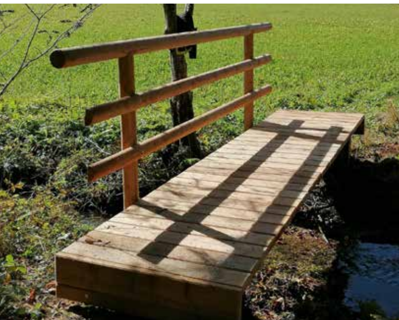
Die Erneuerung einer kleinen Wanderwegbrücke in Gößl wurde aufgrund des schlechten Zustandes erforderlich“.
